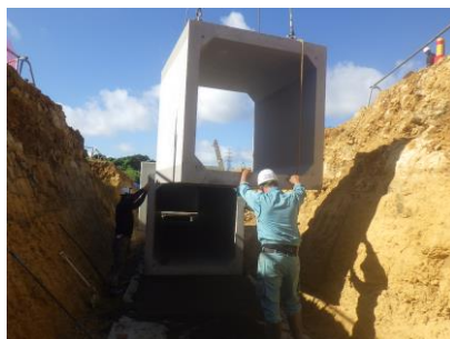
雨水管渠の整備状況
