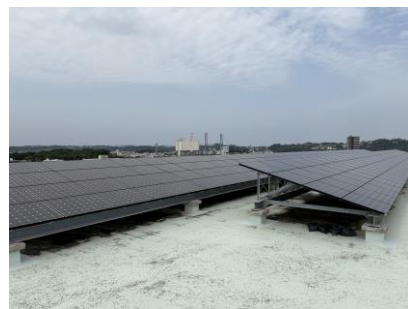
再生可能エネルギー導入事例 (庁舎別館)
