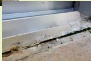
蟻酸で溶かされて巣が作られたサッシまわりの目地▶
