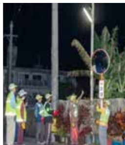
▲ 防犯灯の設置、定期点検
