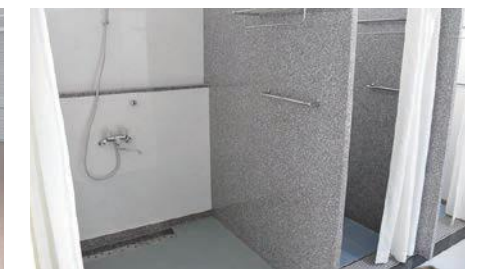
▲ロッカールームやシャワー室も完備
