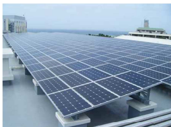
太陽光発電パネル 80kw
