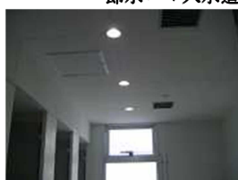
LED照明(トイレ)
