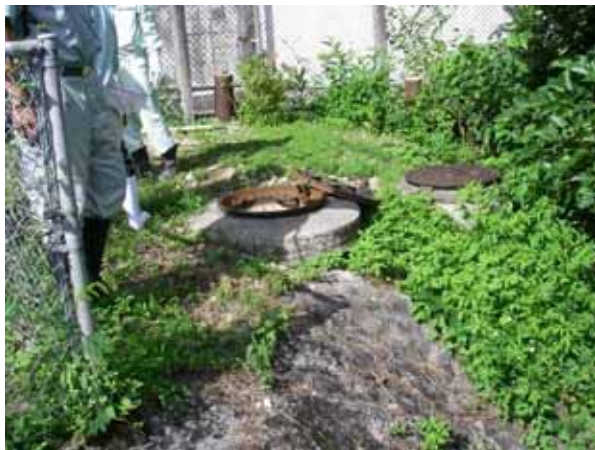
フルチンガー (マンホール入り口)
