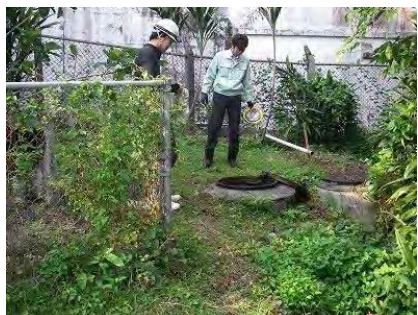
フルチンガー入口マンホール
