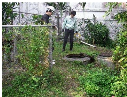
フルチンガー入口マンホール
