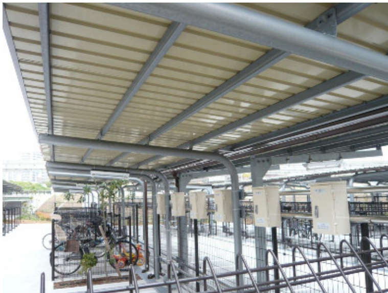
駐輪場に設置されている電気バイク用の充電器
