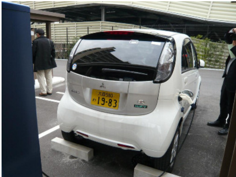
分譲マンション（エルグレース彩都箕面）敷地内に設置されている電気自動車の充電器
