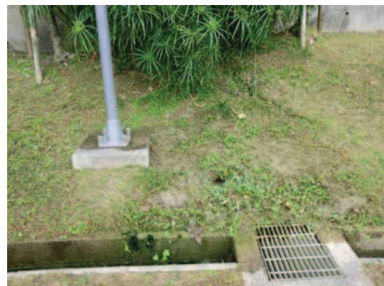
写真 2-9 公園の東切土面からの湧水 風化泥岩上面の小さな水みち（穴）から湧水が見られる
