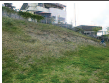
写真 1-13 公園東切土面上部に露出する島尻泥岩 泥岩は角礫状に風化し、表層崩壊が発生している
