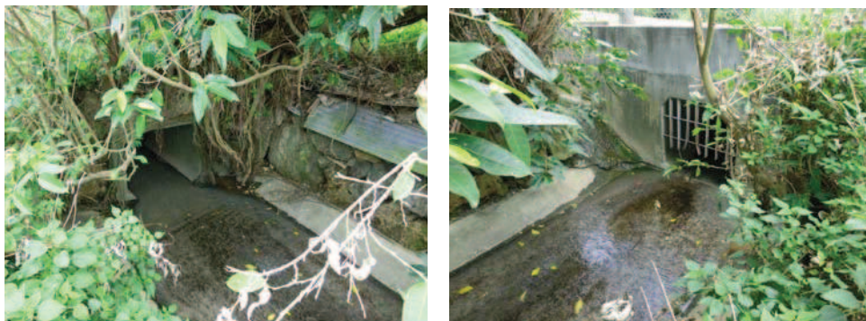
写真 2-10 谷埋め盛土の暗渠の流水（左：出口、右：普天間飛行場内への入口） 中学校西側の大きな谷で、生活排水の混じる地下水が普天間飛行場内へ流れこんでいる
