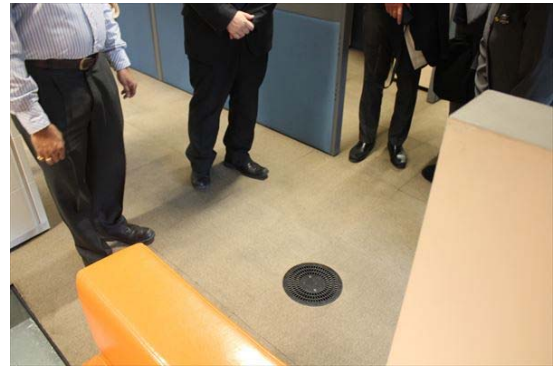
床面からの冷房装置
