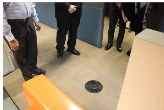
床面からの冷房装置
