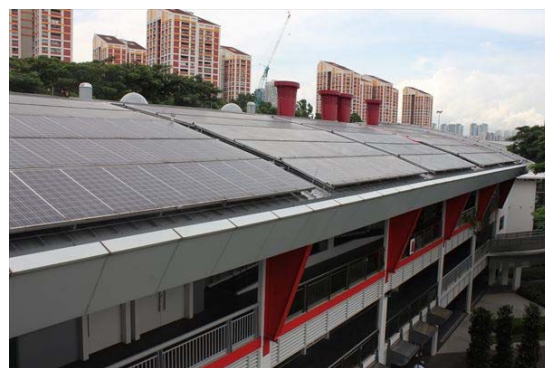
屋上の太陽光発電施設や換気塔
