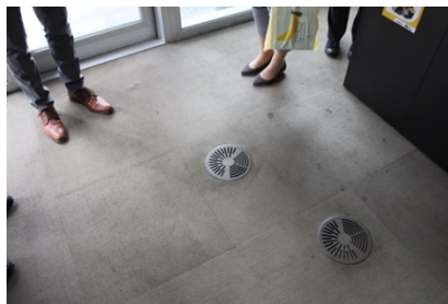
床面からの冷房装置
