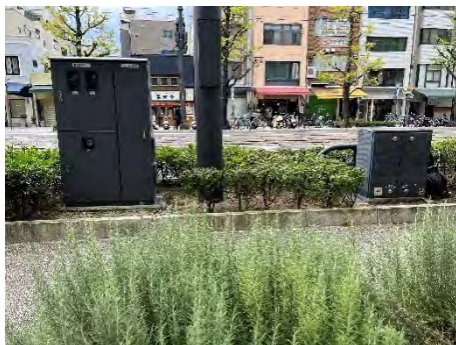
50m 間隔で設置されている電源設備 (イベント等使用可能)
