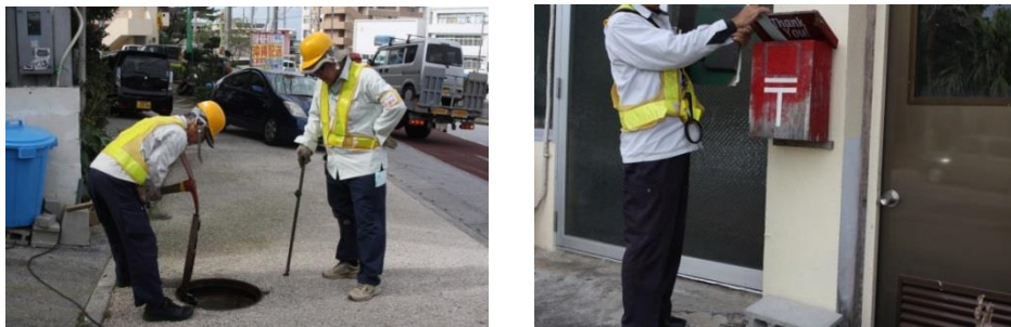
写 3.4.2 シルバー人材活用による接続調査や普及活動
