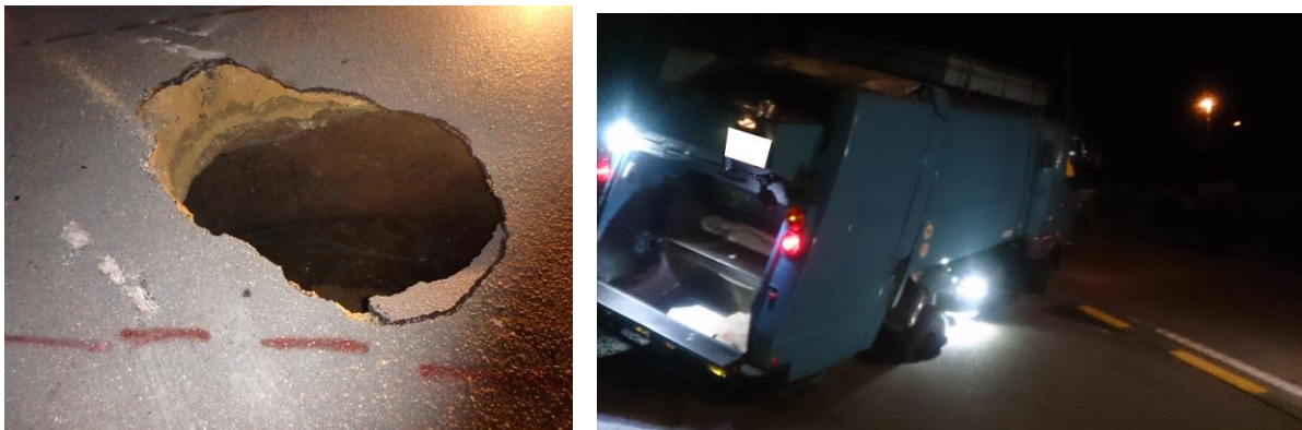
写 3.1.1 本市の道路陥没状況
