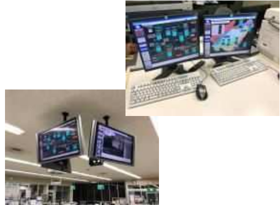
写 2.4.9 計装システムによる監視
