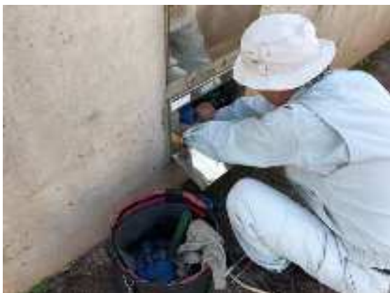
写 2.4.4 水道メーター検針及び取替業務
