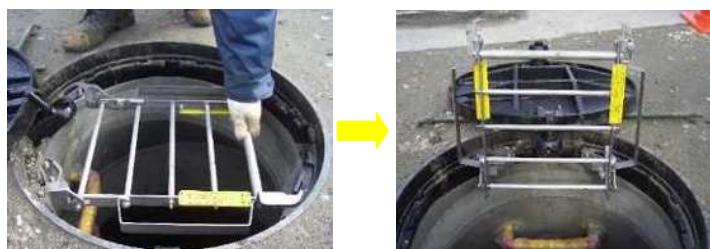
図 3.2.14 転落防止機能の作動確認
