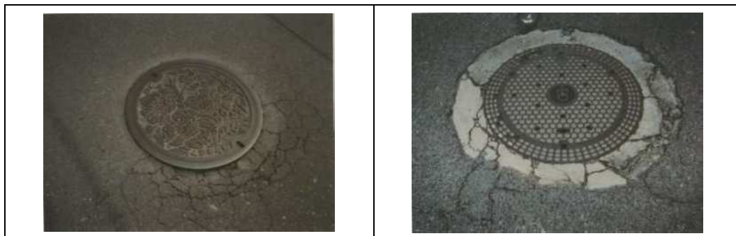
図 3.2.21 周辺舗装の損傷
