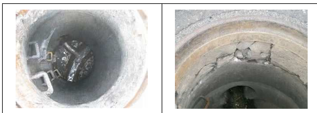
図 3.2.33 マンホール内部写真の撮影（左）、高さ調整部の損傷の撮影（右）
