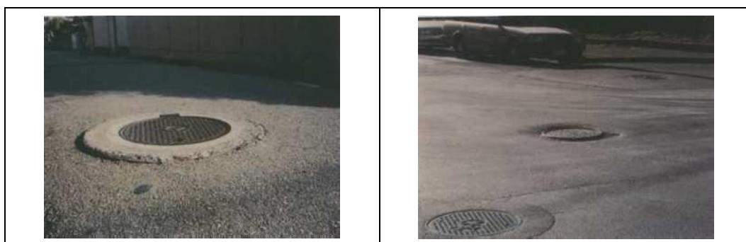
図 3.2.19 蓋・周辺舗装の段差
