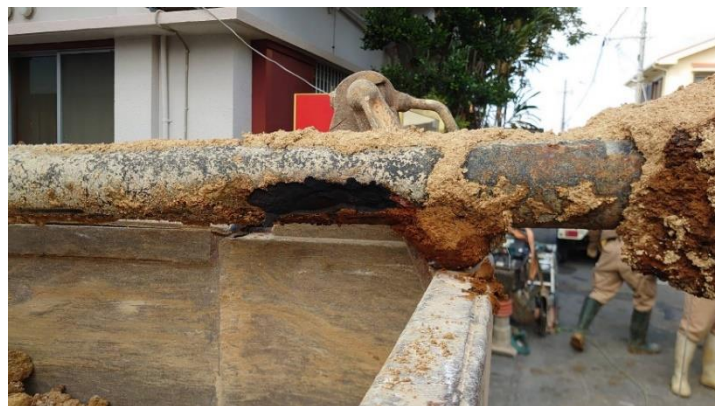
老朽化した配水管
