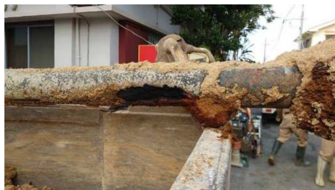
老朽化した配水管
