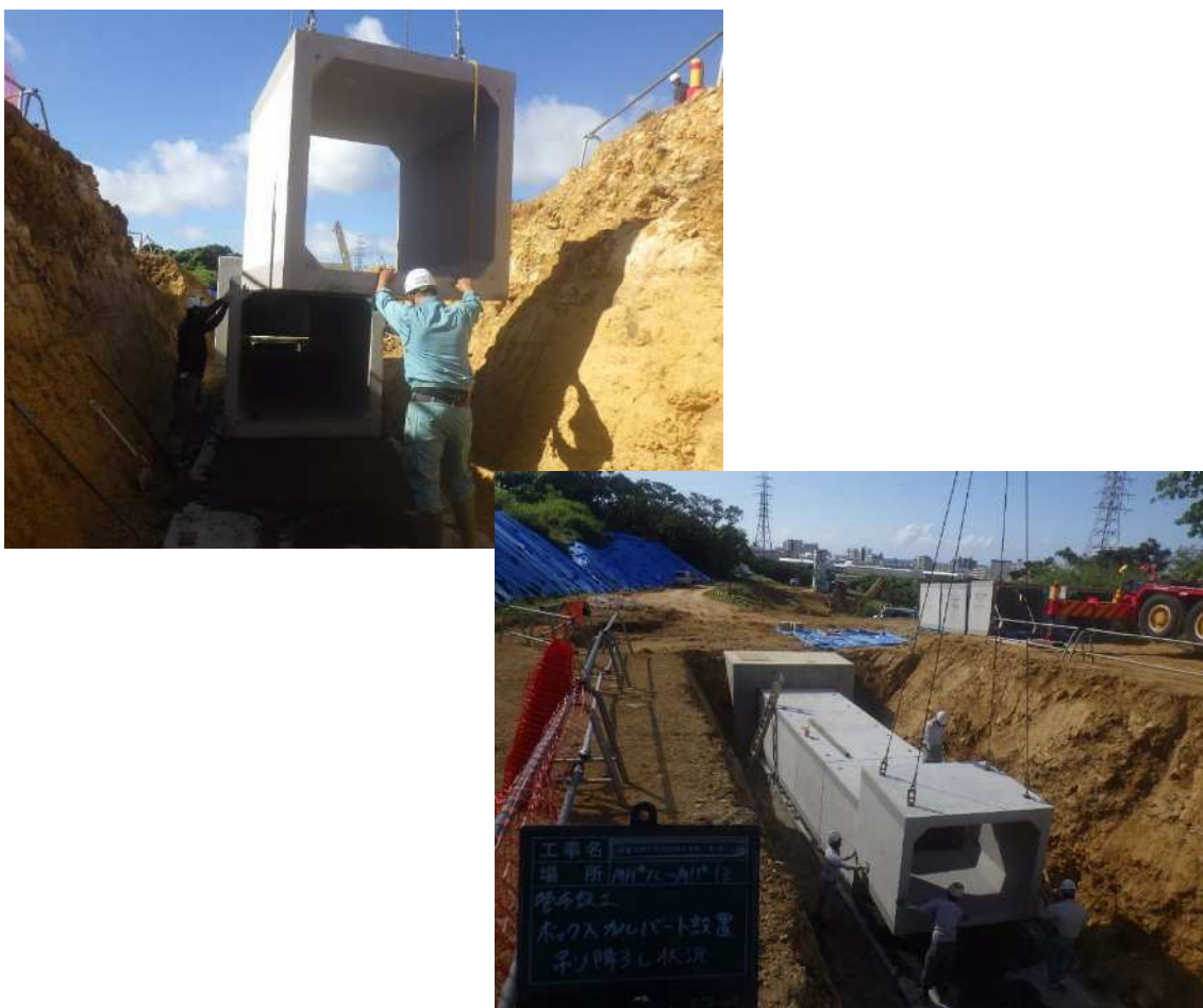
雨水管渠の整備状況
