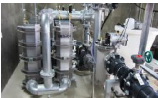
宜野湾小プール濾過器 (公共施設維持修繕事業)
