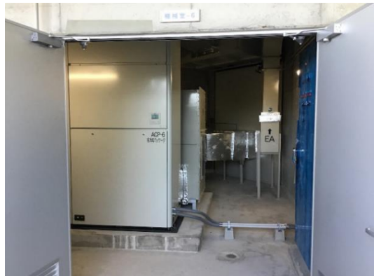
大山小学校防音機能復旧事業(室内機)
