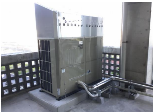
大山小学校防音機能復旧事業(室外機)
