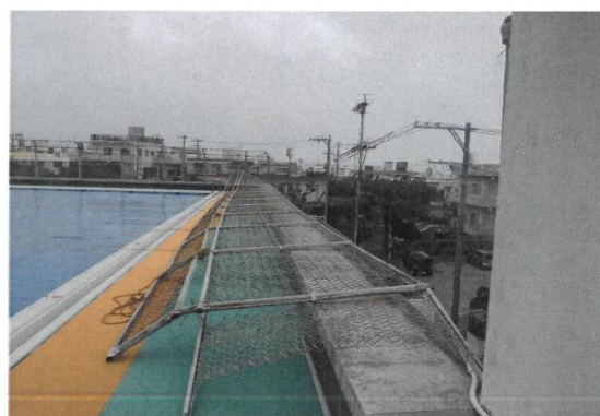
宜野湾小学校プールフェンス台風被害(施工前)
