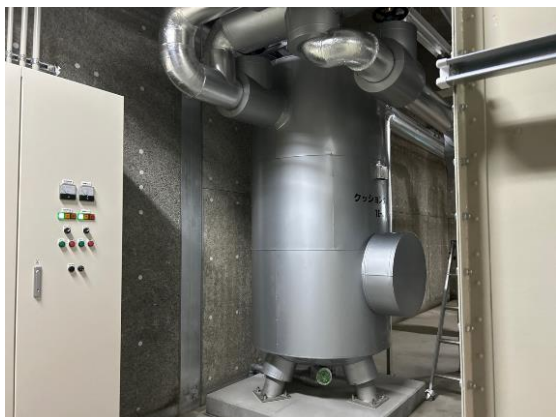
普天間第二小学校防音機能復旧(クッションタンク)
