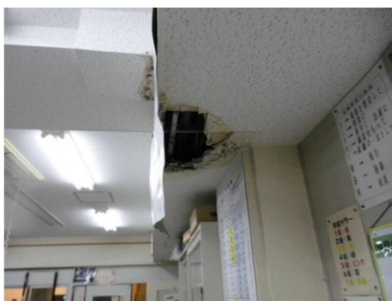
宜野湾中学校職員室天井 修繕前
