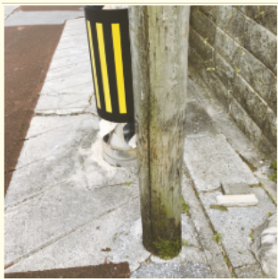
▲木製電柱 1967年当時はコンクリート製の電柱ではなく木製電柱が使用されており、現在も1本残っていました。
