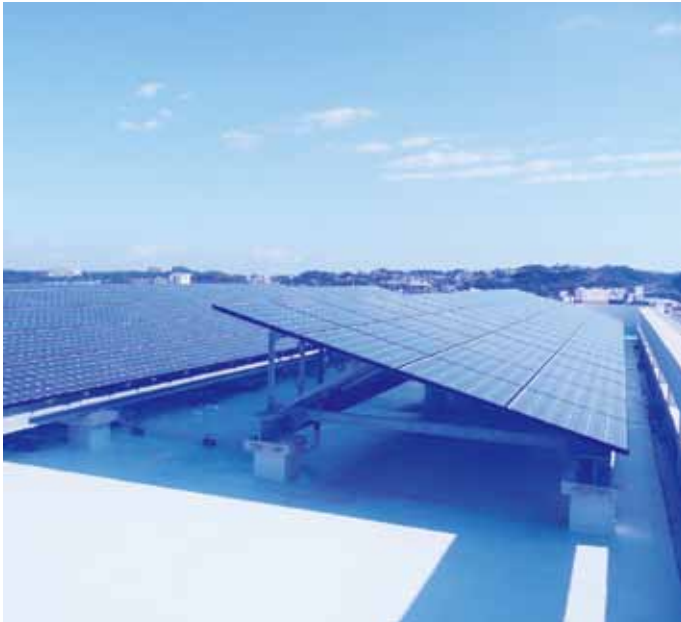
市庁舎別館の屋上に設置されている太陽光発電システム
