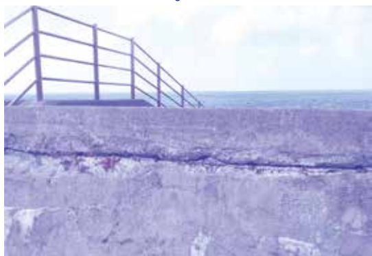
ひび割れ等がみられる伊佐海岸堤防
