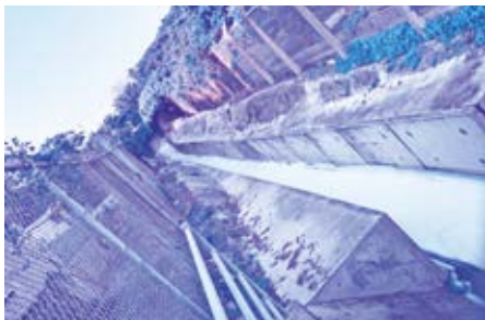
さつき保育園隣の側溝を流れる泡消火剤
