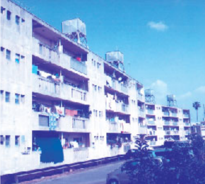
老朽化した伊佐市営住宅
