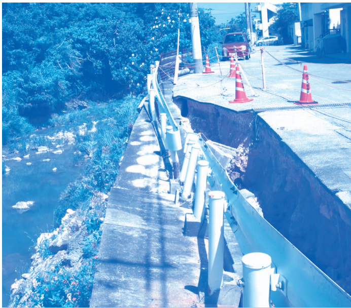
大雨により護岸が崩壊した宇地泊川(5月28日時点)
