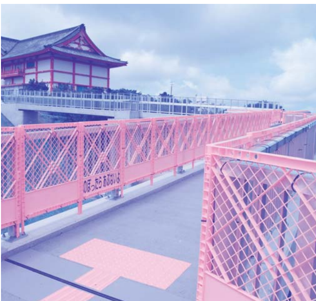
危険と指摘された箇所に、仮の安全対策を実施
