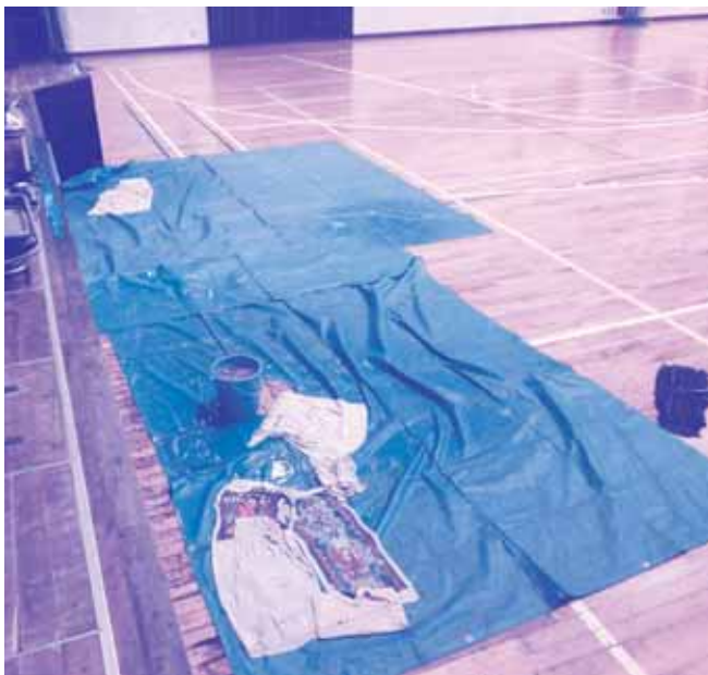
早期の対策が求められる宜野湾中学校体育館の雨漏り状況
