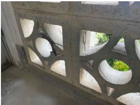
▲G号棟花ブロック爆裂あり 玄関ポーチの花ブロックにも爆裂がみられる。
